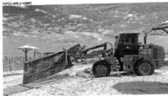
DEMOLIÇÃO TOTAL: A BARRACA FOI EXPANDIDA PARA ÁREA NÃO PERMITIDA DA FAIXA DE AREIA. MPF ENTROU COM PEDIDO EM AÇÃO
